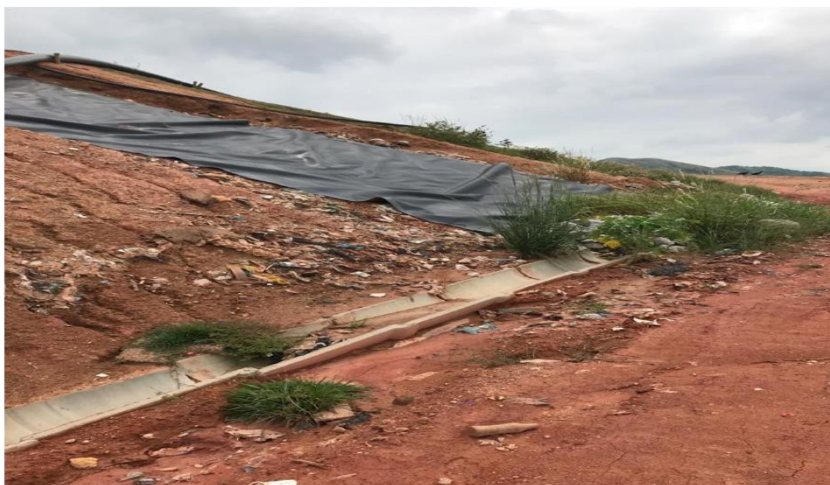
Figura 77 - Acúmulo de resíduos a céu aberto, erosões nos taludes do maciço sem cobertura vegetal e canaletas rompidas – CTR Ciclus
