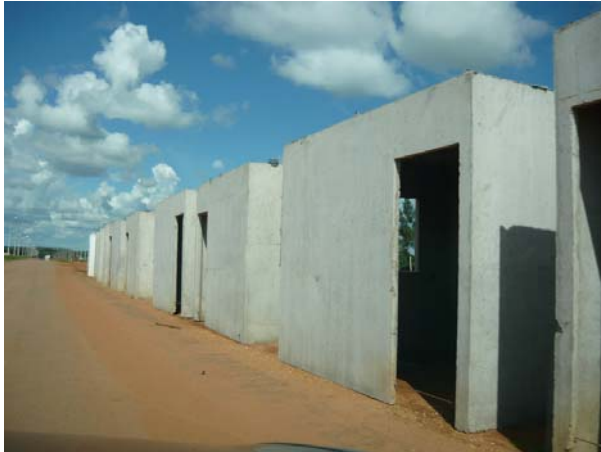
Figura 41: Blocos da casa pré-moldada. Vila da Sadia, Lucas do Rio Verde. (Foto: Betty Rocha, 2008).
