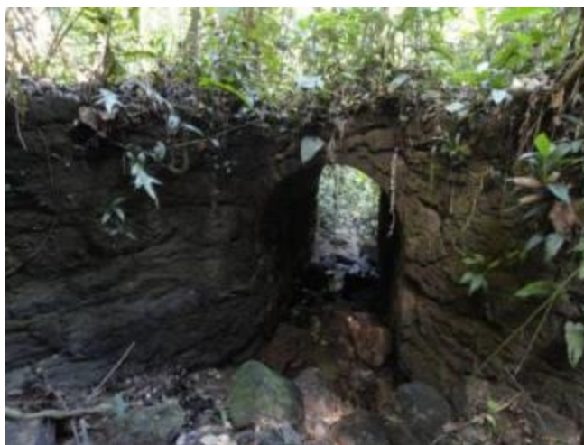
Figura I-8: Passagem de água remanescente, para captar e direcionar o fluxo da água, construída com pedras amontoadas sobre drenagem intermitente, próximo a Trilha do Caminho dos Escravos, no PNMCP.
