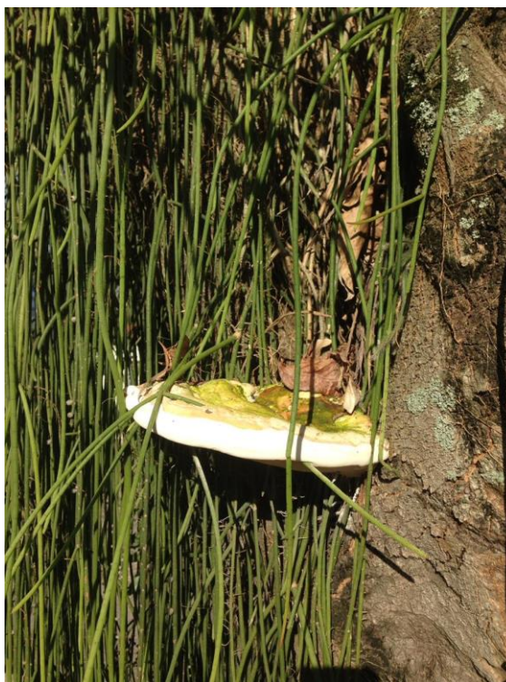
Figura 26 - Corpo de frutificação de fungo biodeteriorador.
