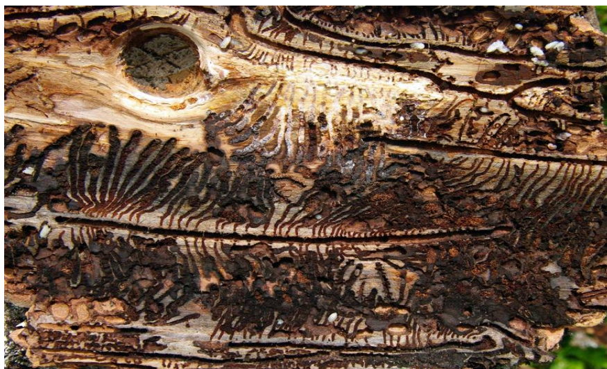
Figura 5. Danos em peças de madeira causados por insetos xilófagos.
