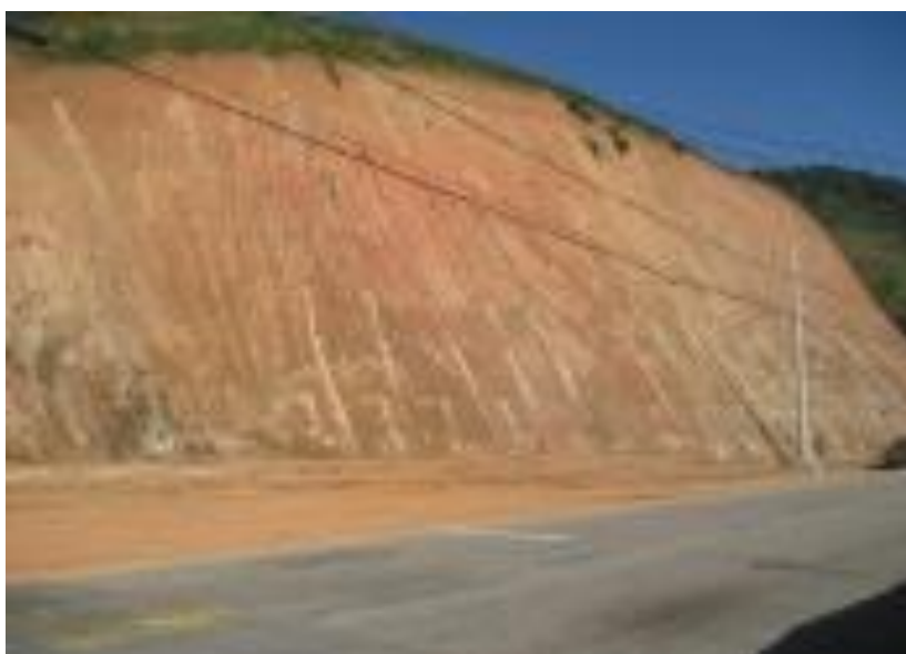
Figura 8: Talude exposto, à margem da rodovia RJ 17 ( município de Engenheiro Paulo de Frontin).
