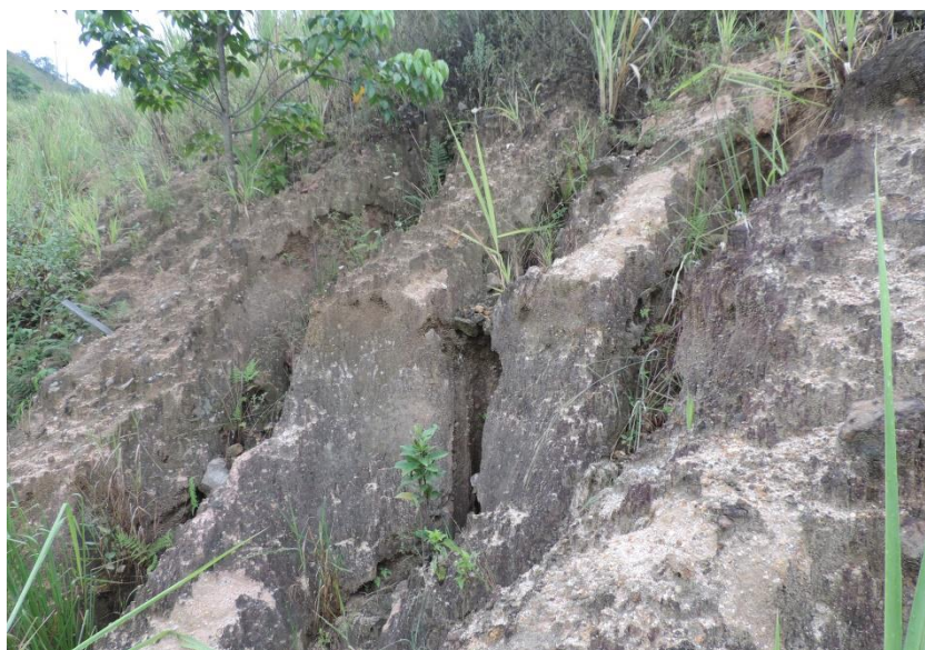
Figura 13: Presença de avançados processos erosivos no talude do tratamento G1 (sem medida, face oeste).
