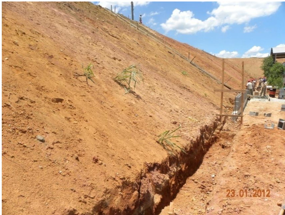
Figura 03: Aterro de subsolo no início de 2012, etapa da construção, em Queimados, RJ.
