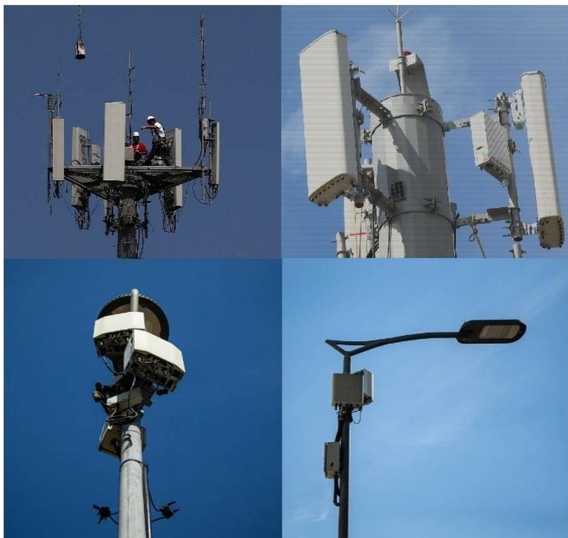
FIGURA 6 - AS NOVAS ESTRUTURAS PARA A TRANSMISSÃO DA REDE DA TECNOLOGIA 5G
