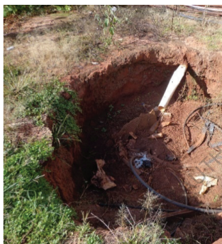
Figura 6: Fossa séptica em má conservação
