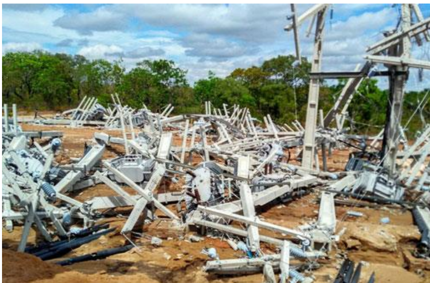
Figura 32 – Rede elétrica da empresa Igarashi danificada após manifestação contra a captação intensiva da águas em Correntina (2017)
