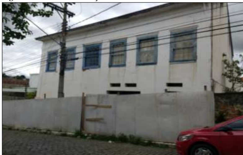
Figura 37: Início de destruição de um imóvel tombado em Resende – RJ.
