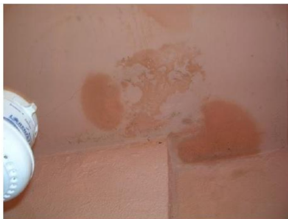
Fig.III.46 Umidade no forro de gesso. Foto do autor, 2007.
