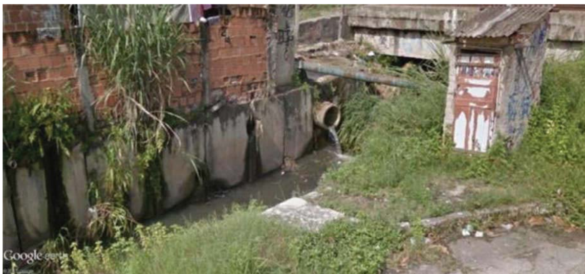
Figura 41: Esgoto doméstico no canal Maxambomba Fonte: Google Earth (2017)
