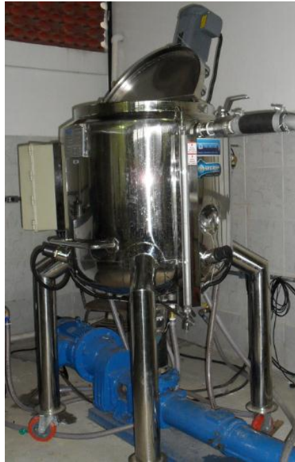
Figura 12: Foto do tanque da unidade.
