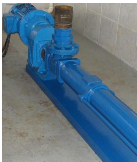
Figura 11: Bomba helicoidal de 25HP e 12 kgf.cm -2 de pressão de descarga.
