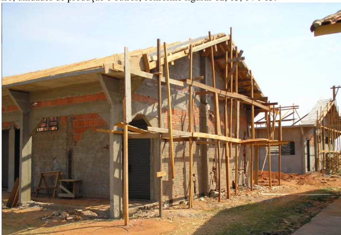
Figura 02 – Obras de reforma e ampliação das unidades que hoje constituem as principais instalações físicas do Campus Campo Novo do Parecis
