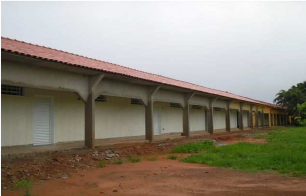
Figura 03 – Obras de reforma e ampliação das unidades que hoje constituem as principais instalações físicas do Campus Campo Novo do Parecis Fonte: Arquivo IFMT- CNP.
