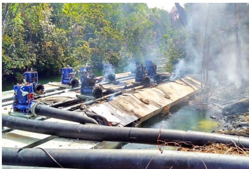
Figura 31 – Estrutura de captação de água da empresa Igarashi destruída após manifestação contra a apropriação intensiva em Correntina (2017)
