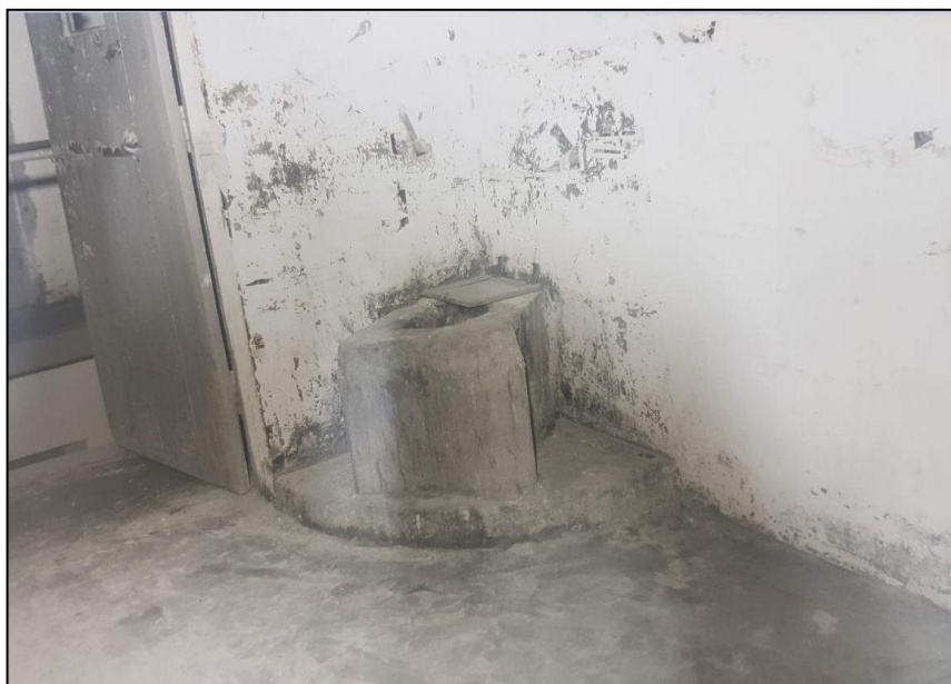
Figura 26 - Vaso sanitário da tranca de isolamento
